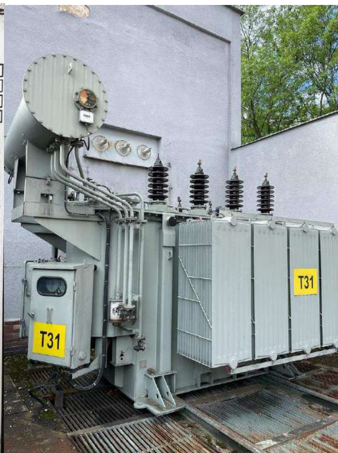
Spoljašnji izgled transformatora 35/10kV, 10MVA
